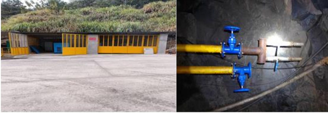
+172m 斜坡道口空压机房和井下供气口阀门
