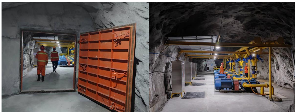
+80m 中段水泵房防水门、水泵房水泵、开关柜、排水管布置
