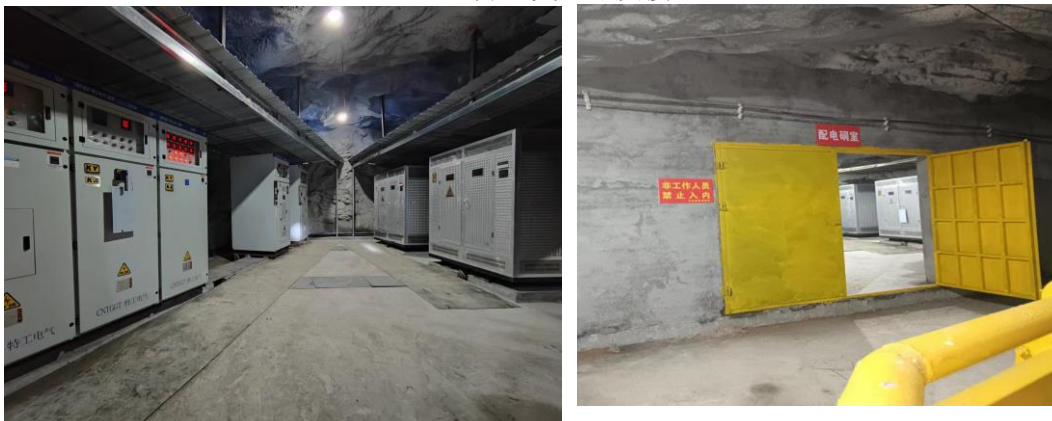
+80m 中段水泵房配电室
