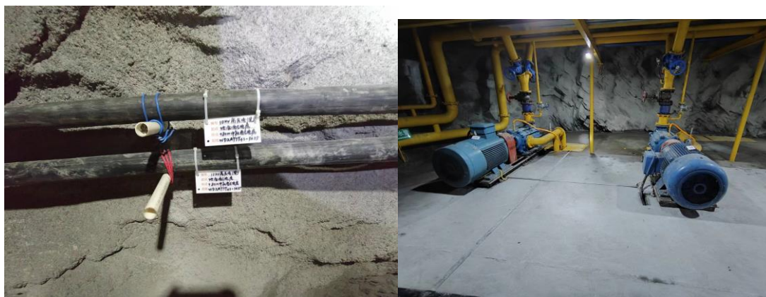
井下电缆型号和+80m 水泵房接地网
